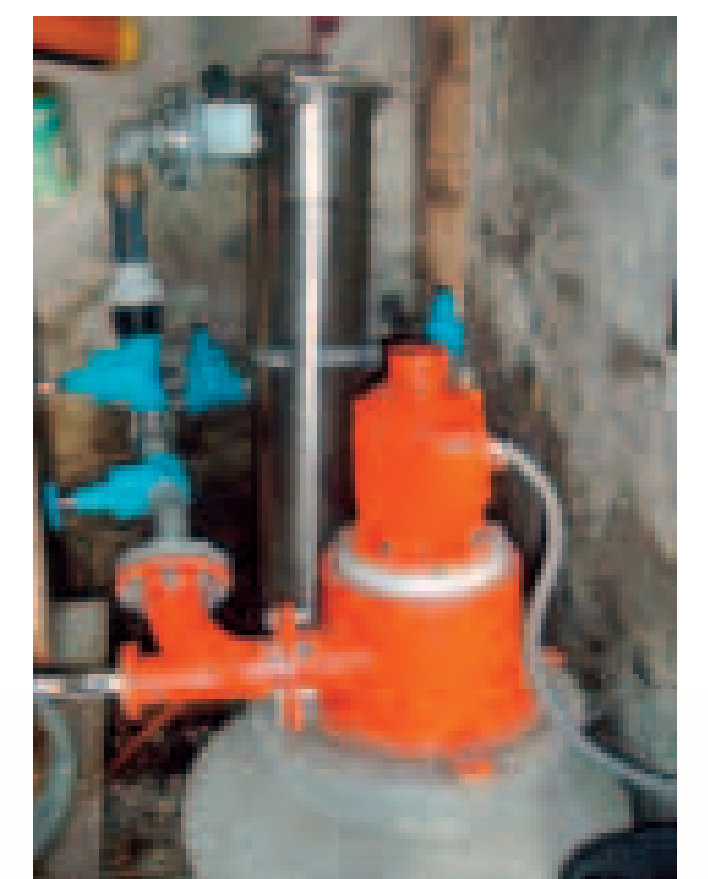
Die in die Wasserversorgung integrierte Turbine
